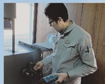
ダクト内測定、風洞実験に
