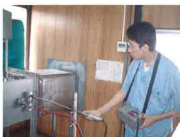
排気ダクトの測定に
